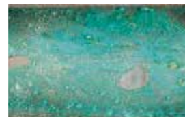
KORROSION DURCH ABLAGERUNGEN Durch unzureichend aufbereitetes Wasser können sich Algen und Schleim ablagern
