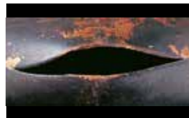
GEFRIERBRUCH Durch zu geringen Wasserdurchfluss im Verdampfer
