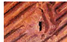
LOCHFRASS VON INNEN Aggressive Elemente im Wasser in hoher Konzentration lassen Löcher entstehen
