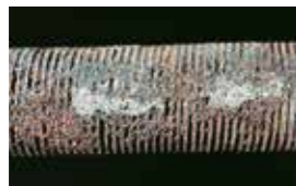
KORROSION VON AUSSEN Verursacht durch eingedrungene Luft
