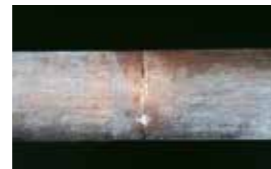
VERSCHEISS DER ROHRHALTERUNGEN Risiken bestehen an den Kontaktstellen zwischen Rohr und Halterung
