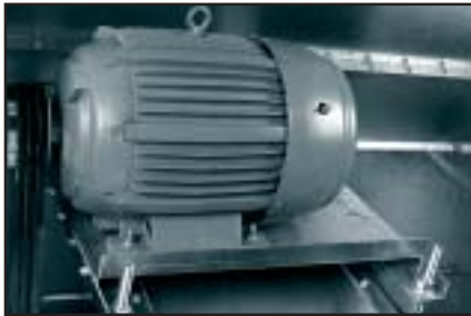
LSTA Ventilatormotor, montiert
