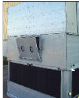
Fill Access Door
