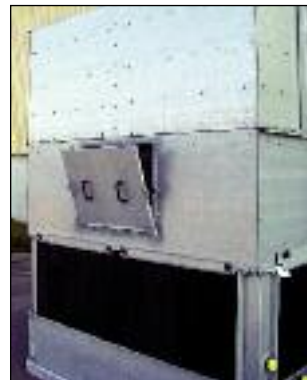
Wartungsluken zu den Füllkörpern
