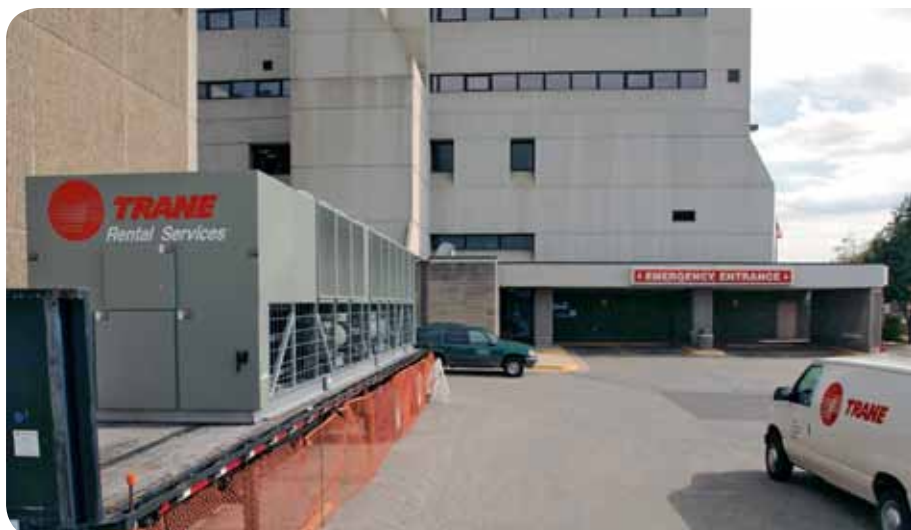
Gemoedsrust met Trane oplossingen voor noodkoeling
